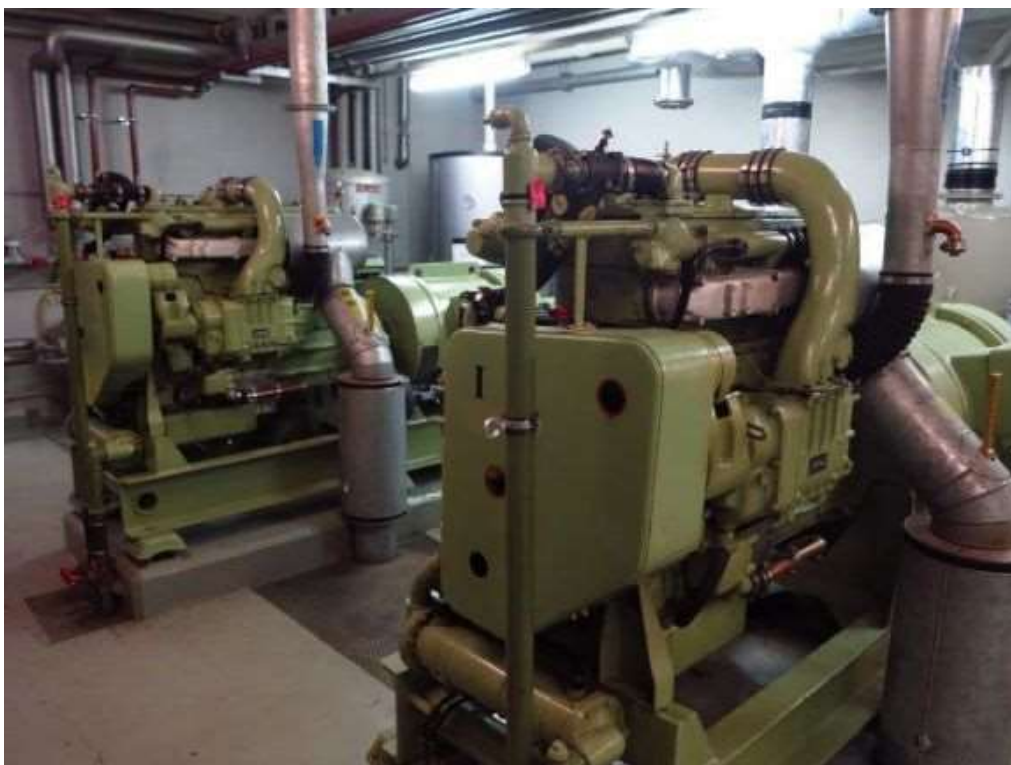
Maschinenraum mit zwei Dieselmotoren und Lüftungssystemen
