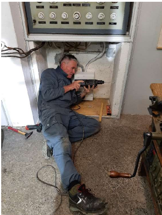
Die Stromversorgung in Lengwil ist wieder hergestellt!
