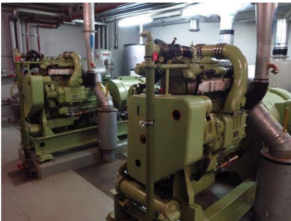
Maschinenraum mit zwei Dieselmotoren und Lüftungssystemen
